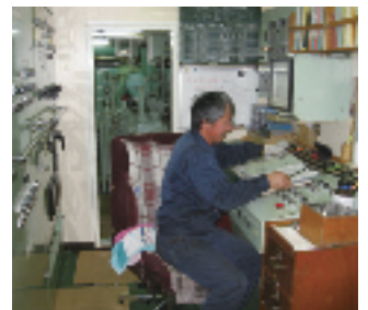
船内には多くの機器が装備されている
