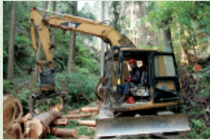
斜面から下ろされた木は、グラップル付バックホウで次々に積み上げられていく。
